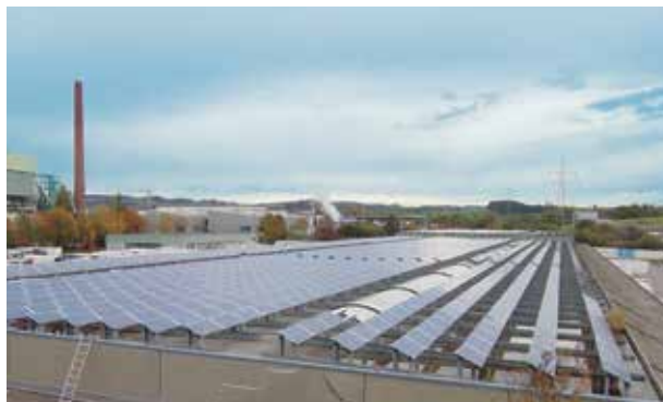
Installation de 324 kW Lebert à Kempten
